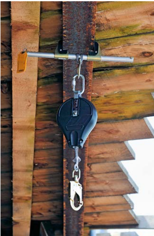
22 An mobilem Anschlagpunkt montiertes Höhensicherungsgerät.
