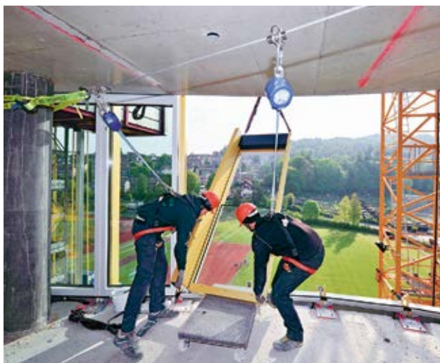
24 Arbeiten an einer Absturzkante.
