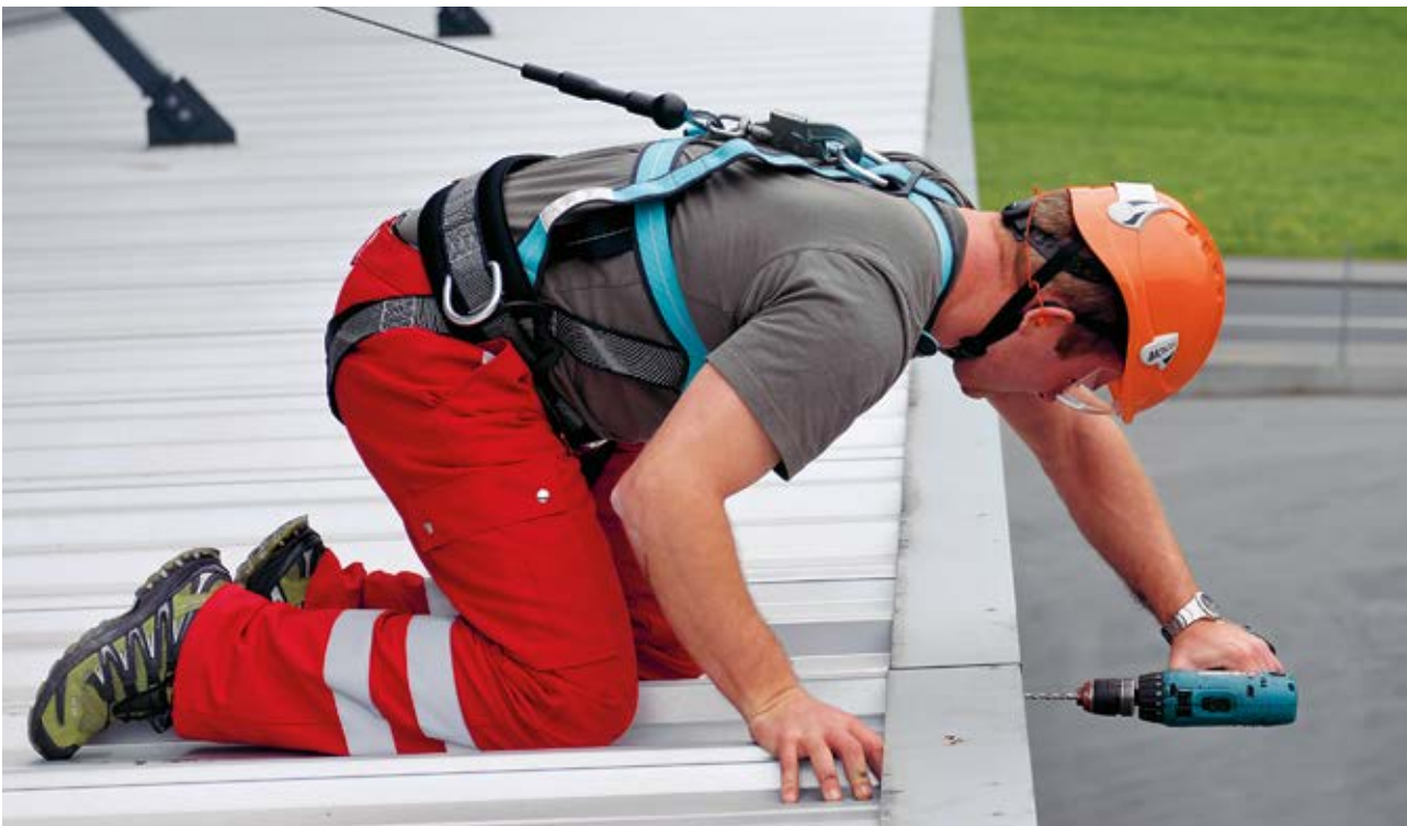
18 Arbeiten an einer Absturzkante.
